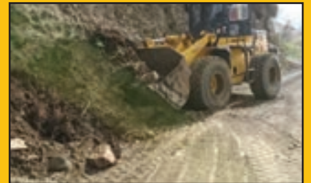
Karaçayır Mh. heyelan temizliği yapıldı
