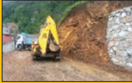
Çukurca Mh. heyelan temizleme
